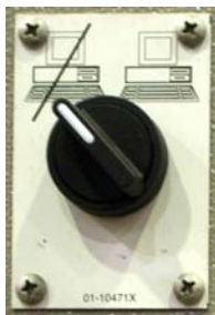
Obrázek [Figure] 6: Mildata/místní volící spínač [Mildata/Local Selector switch]
