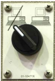
Imagem 5: Interruptor Seletor de Mildata/Local
