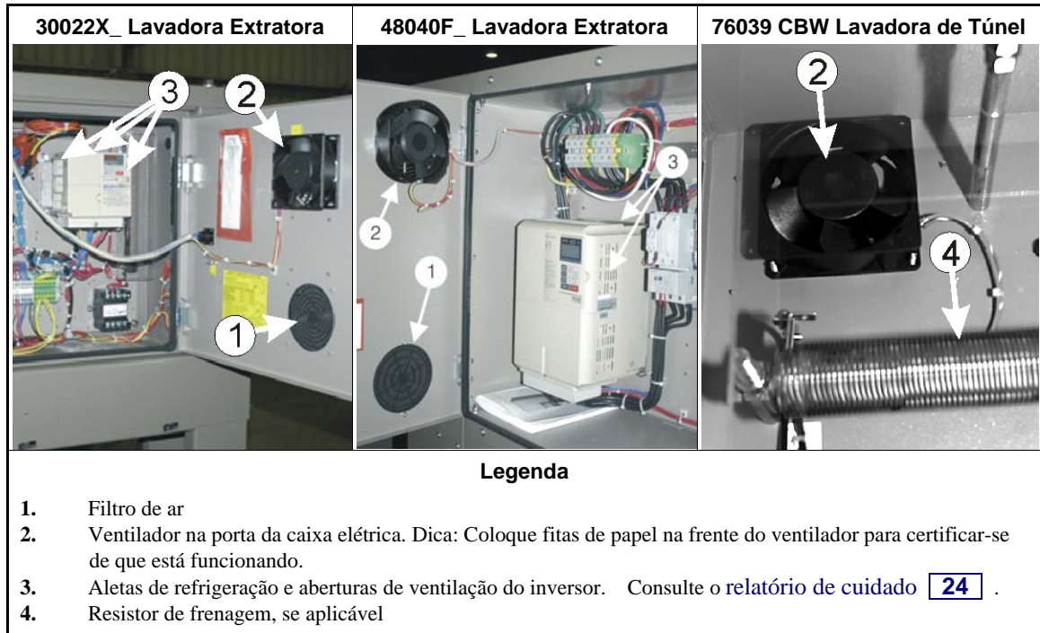
Imagem 8: Caixa elétrica e inversor. Estes são apenas exemplos. Sua máquina pode ter outra aparência.
