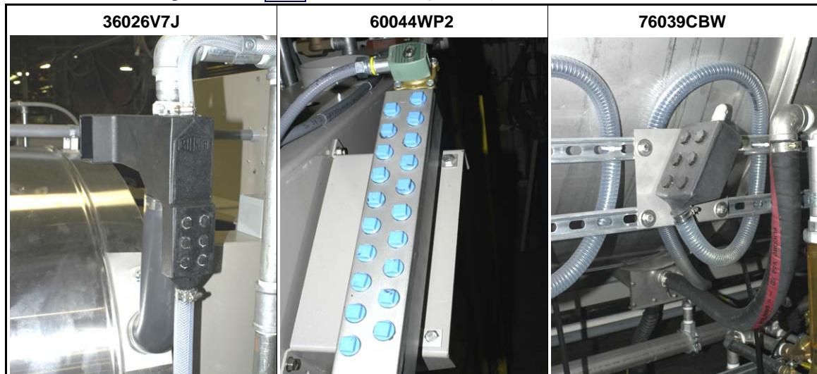
Figura 9: Colectores de entrada de químicos para los sistemas de bomba de químicos. Véase Declaración de precaución 24 . Estos son algunos ejemplos. El equipo puede ser diferente.
