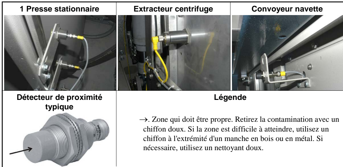
Illustration 12: Détecteurs de proximité Ce sont des exemples. Votre machine peut être différente.
