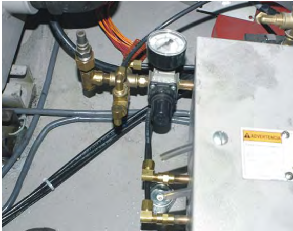
Illustration 14: Manomètre pression d'air et régulateur au-dessus de la plaque supérieure de la porte de déchargement
