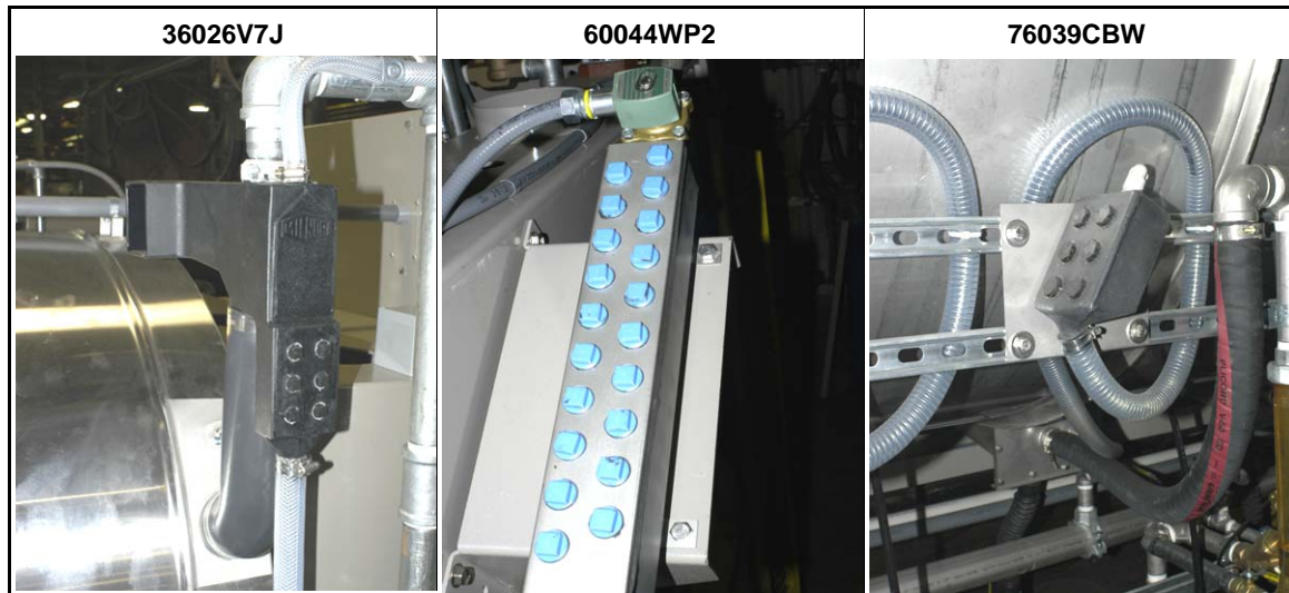
Imagem 9: Tubos de distribuição de entrada de produtos químicos para sistemas de bombas de produtos químicos. Consulte o relatório de cuidado 25. Estes são apenas exemplos. Sua máquina pode ter outra aparência.
