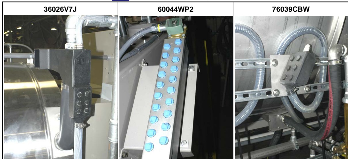
Figura 9: Colectores de entrada de químicos para los sistemas de bomba de químicos. Véase Declaración de precaución 25 . Estos son algunos ejemplos. El equipo puede ser diferente.
