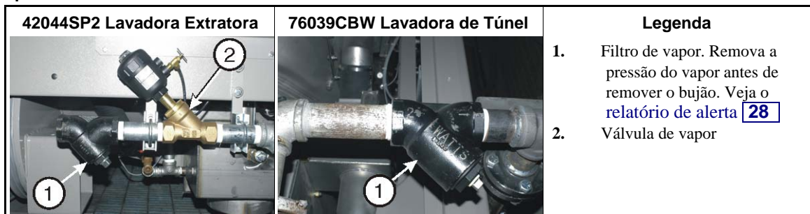
Imagem 12: Filtro de entrada de vapor. Estes são apenas exemplos. Sua máquina pode ter outra aparência.
