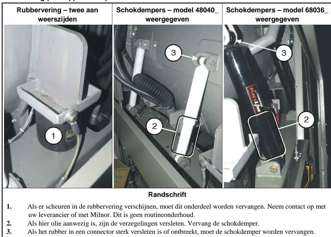
Afbeelding 15: Ophangingsonderdelen aan beide zijden van de wascentrifuge opgehangen aan rubbervering (zie Supplement 3)
