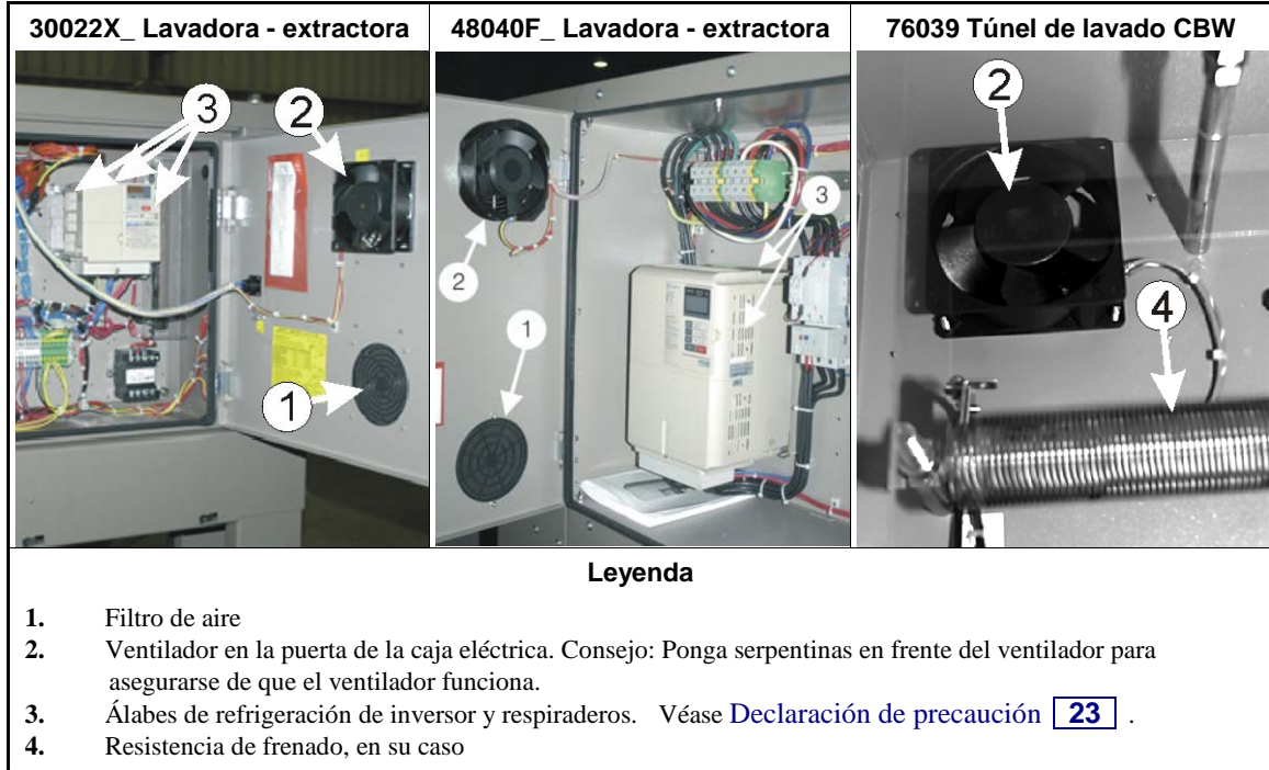
Figura 8: Caja eléctrica e inversor. Estos son algunos ejemplos. El equipo puede ser diferente.
