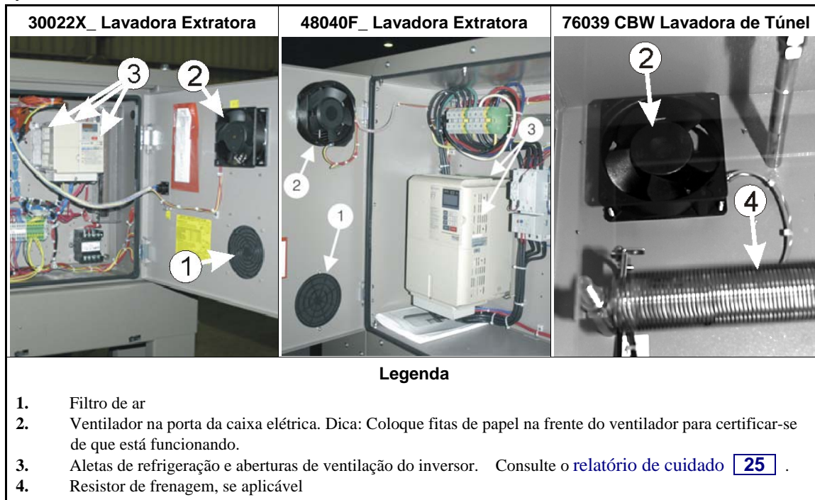
Imagem 8: Caixa elétrica e inversor. Estes são apenas exemplos. Sua máquina pode ter outra aparência.
