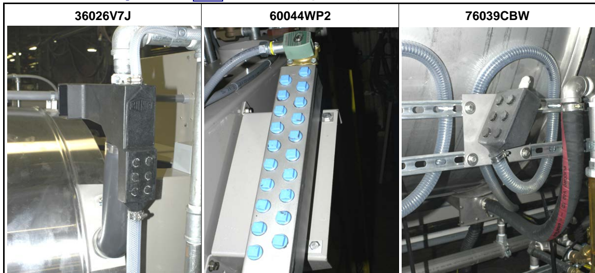
Figura 9: Colectores de entrada de químicos para los sistemas de bomba de químicos. Véase Declaración de precaución 26 . Estos son algunos ejemplos. El equipo puede ser diferente.
