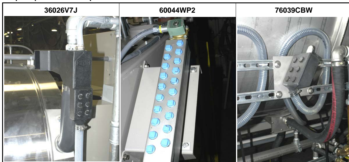
Imagem 9: Tubos de distribuição de entrada de produtos químicos para sistemas de bombas de produtos químicos. Consulte o relatório de cuidado 26 . Estes são apenas exemplos. Sua máquina pode ter outra aparência.
